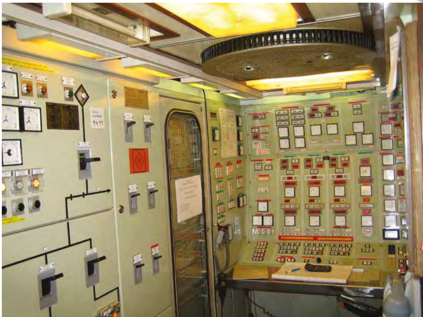
Le PC Machine-Electricité-Sécurité du Verseau. (Raymond Reboul)
